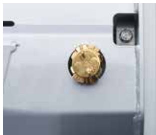
Impianto lavaggio coclea orizzontale
