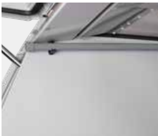
Impianto di lavaggio del serbatoio neve
